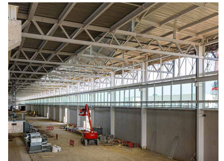
Le hall de maintenance des véhicules (VMI) permet aux véhicules de maintenance d'être réparés.
