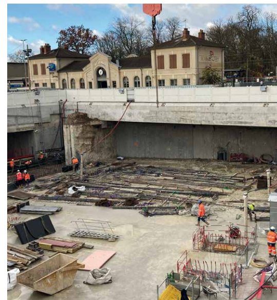
Le béton est coulé pour former le plancher du premier niveau souterrain.
