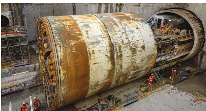
Après son percement, le tunnelier Mireille a été déplacé d'une extrémité à l'autre de la gare, une opération appelée « ripage ».
